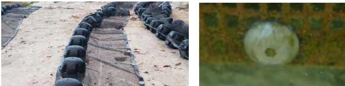
Figure 29 : Ecrous et vis des séquences assurant le lestage du filet (Source : SUEZ CONSULTING)
